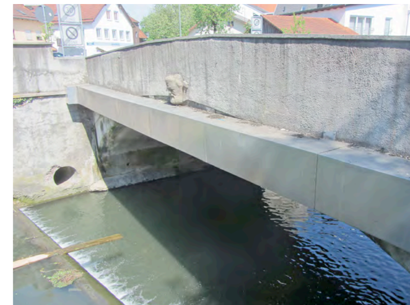
Weil die Fehlbachbrücke in der Freisinger Straße marode ist, wird sie ab Mitte Juni abgebrochen und durch eine neue ersetzt.
