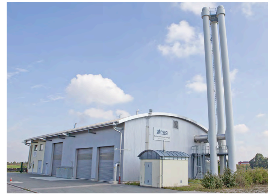
Mit zwei Heizkraftwerken (wie hier am Kletthamer Feld) versorgt der Zweckverband für Geowärme einen Großteil Erdings mit Fernwärme.
