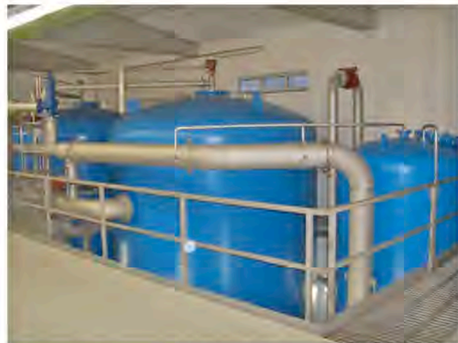
Bild: Die Filtration im Wasserwerk Erding
